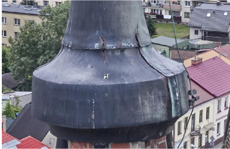
zdj. 49 Uszkodzenia i pęknięcia hełmu na kolejnej wieży
