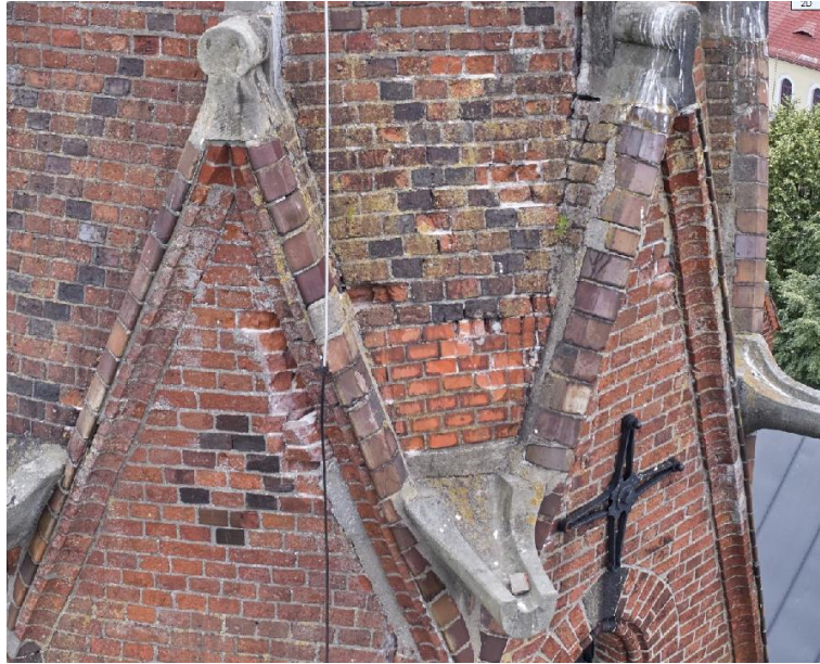
zdj. 46 Ubytki i uszkodzenia
