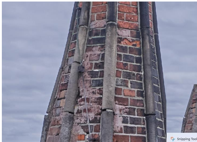
zdj. 34 Spękania wieży południowej
