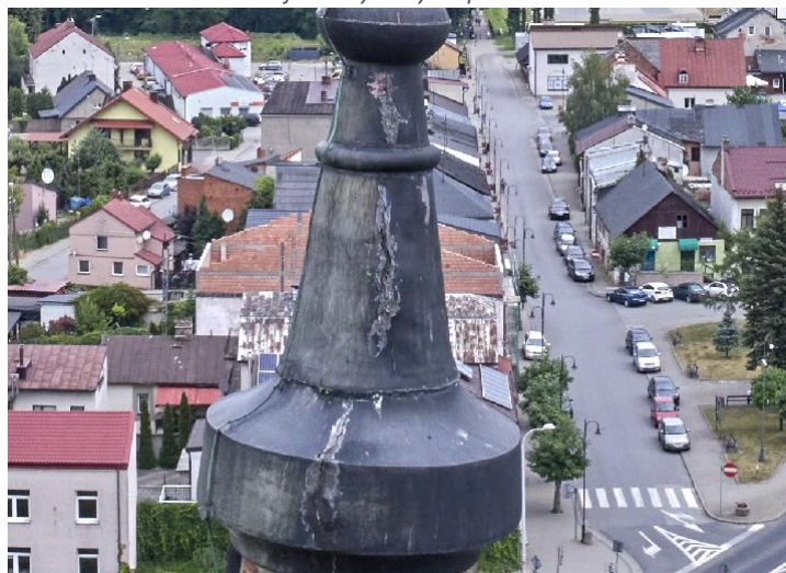
zdj. 48 Pęknięcia i uszkodzenia hełmu
