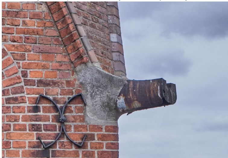
zdj. 53 Uzupełnienia ubytku z blachy
