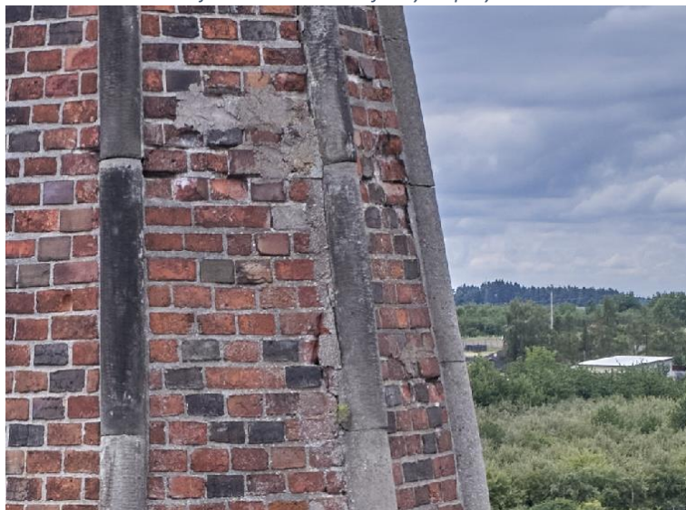
zdj. 41 Fałszywa patyna , ubytki i spękania
