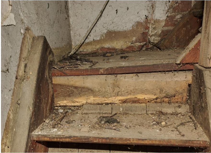
zdj. 33 Deska podstopnicowa porażona przez techniczne szkodniki drewna
