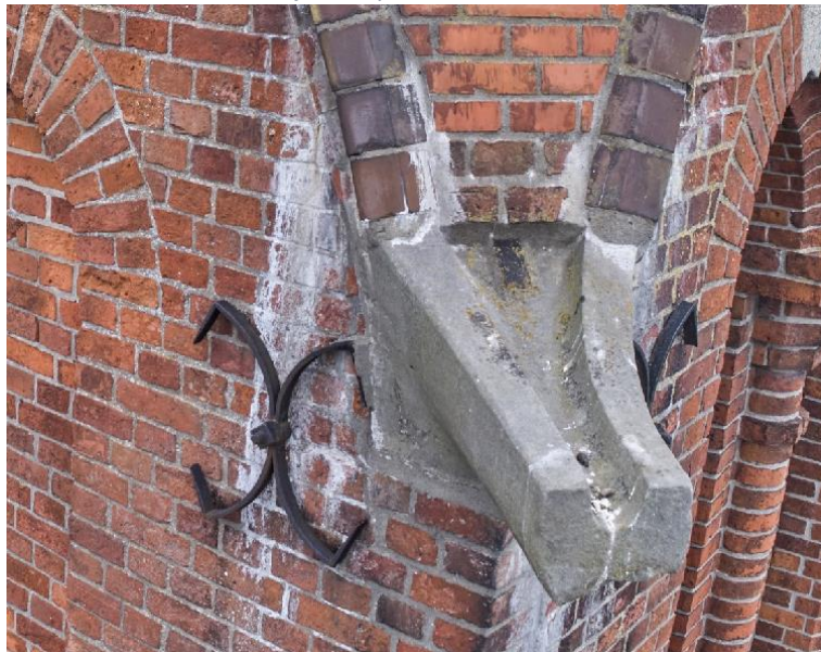
zdj. 47 Wykwity wapienne
