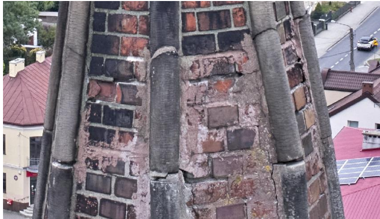
zdj. 38 Uzupetnienia i spękania na szczycie wieży
