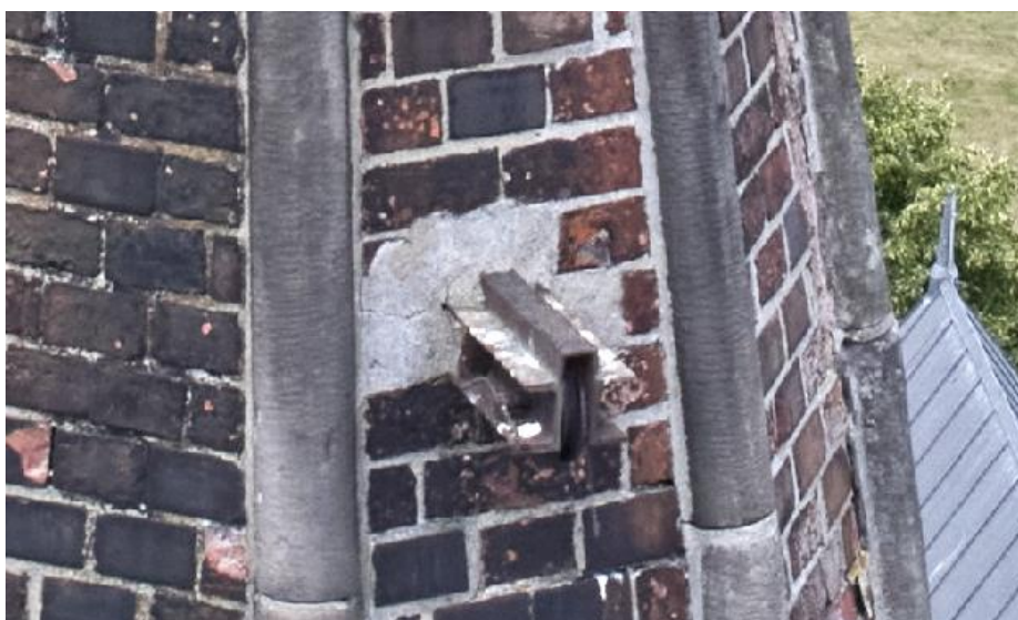
zdj. 20 Wtórny bloczek na szczycie dachu szpałdowany zaprawą cementową
