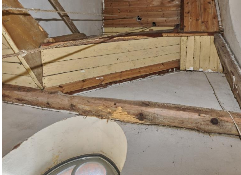
zdj. 29 Porażona belka schodów w wieży północnej
