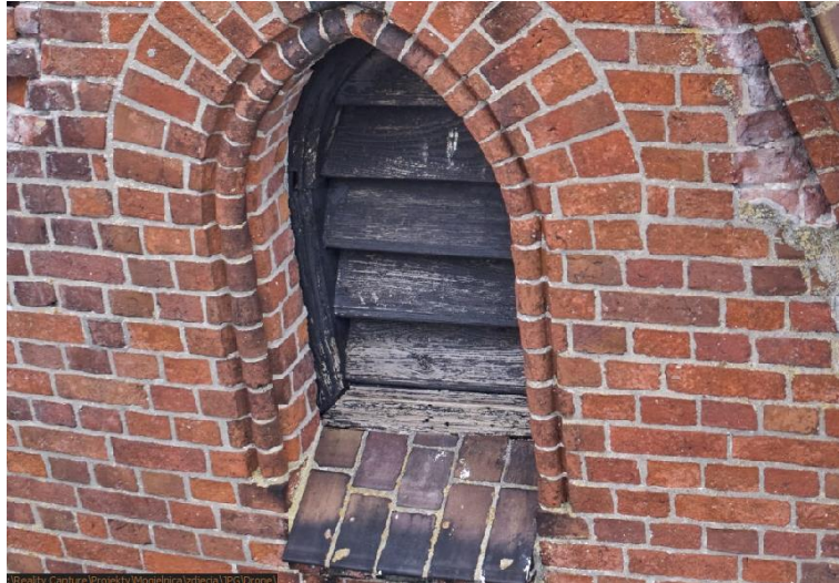
zdj. 52 Brak powłoki ochronnej na drewnianych żaluzjach.
