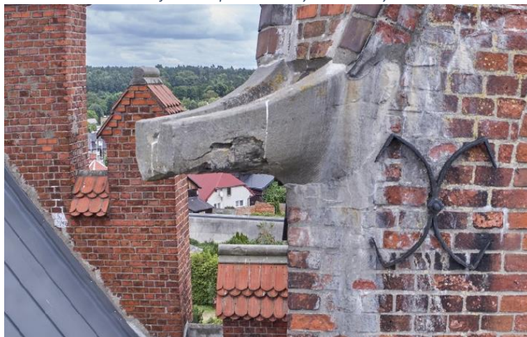
zdj. 54 Ubytki na żygaczu
