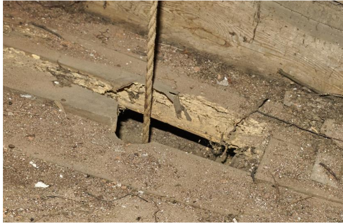
zdj. 26 Porażenie stropu pod konstrukcją dzwonów w wieży północnej
