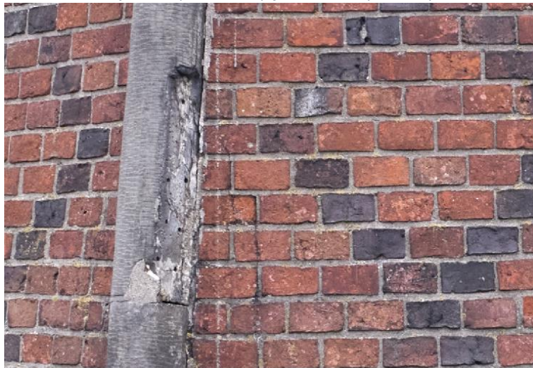
zdj. 39 Ubytki kamieniarki
