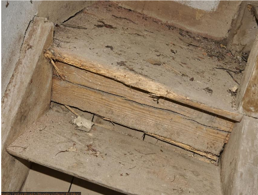
zdj. 31 Porażone deskowanie spocznika oraz deski podstopnicowej w schodach północnych
