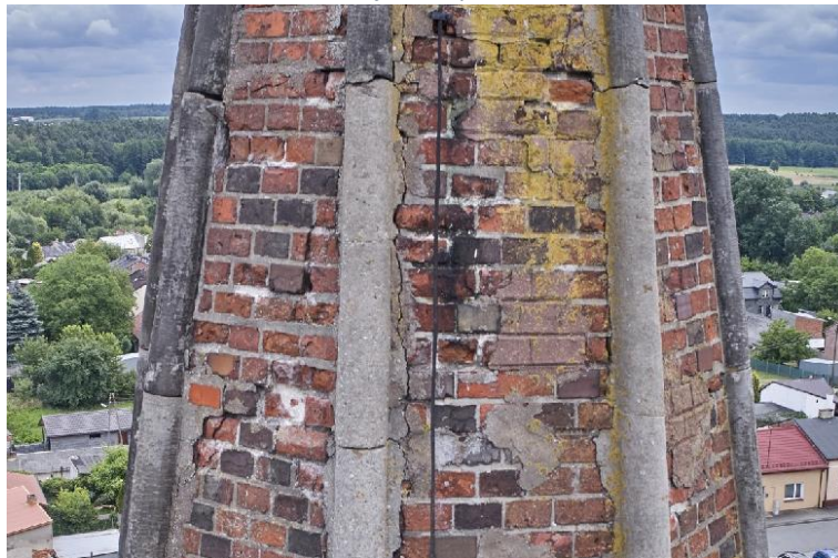
zdj. 44 Spękania, ubytki, uzupełnienia , kopie gąsiorów
