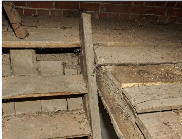
zdj. 27 Porażona podłoga stropu przy ostatnim biegu schodów w wieży północnej
