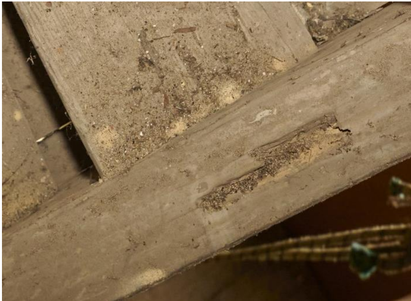
zdj. 32 Świeża mączka drzewna z otworów wylotowych na schodach w wieży północnej
