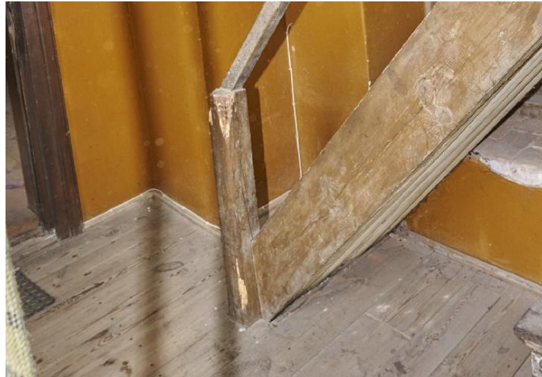
zdj. 28 Porażony słupek balustrady przy schodach w wieży północnej
